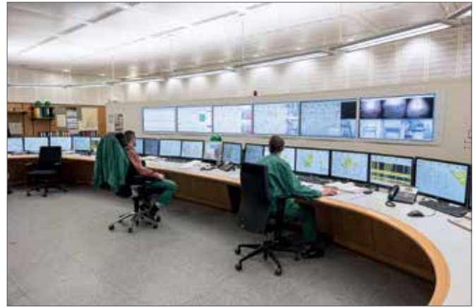
Das Prozessleitsystem Simatic PCS 7 erlaubt mittels Open OS die Integration aller Komponenten unterschiedlicher Hersteller sowie der gesamten Gebäudeleit- und Schalttechnik.
